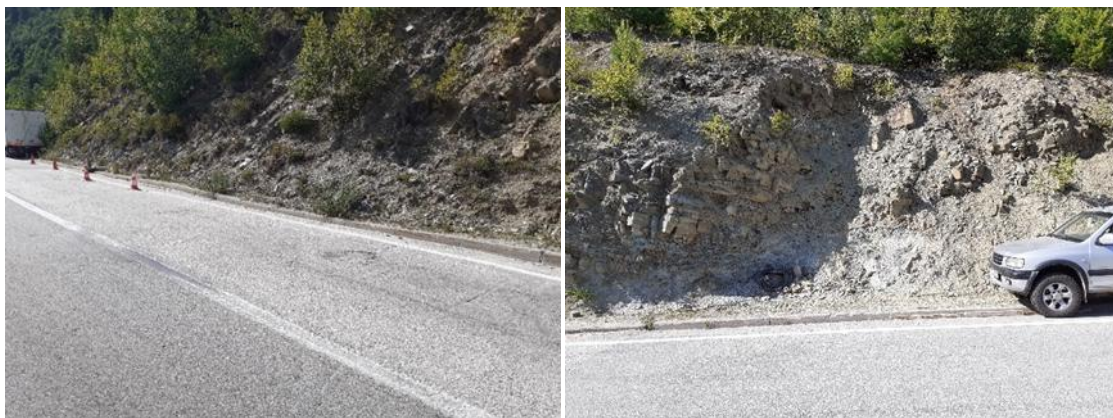
Ispoljene deformacije asfaltiranog kolovoza (lijevo) i pojava obrušavanja pokosa (desno)
