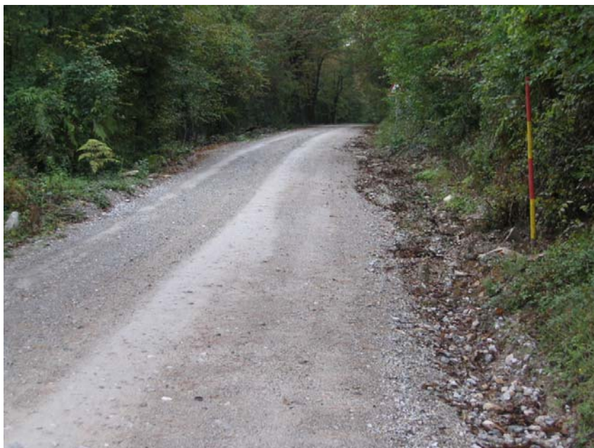
Primjer posljedica tečenja vode po desnom rubu kolovoza
