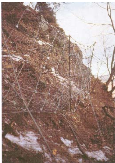
Slika 6.46: Mreže nude zaštitu pred padajućim kamenjem i snježnim lavinama
