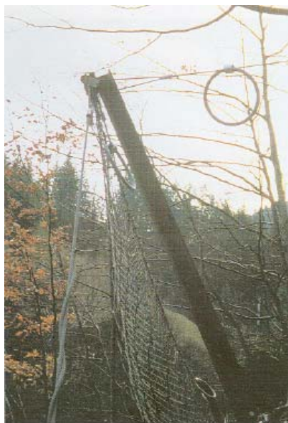
Slika 6.47: Zaštita pred snježnim lavinama i padajućim kamenjem sa pruženim lovećim mrežama iz čeličnih pletenica
